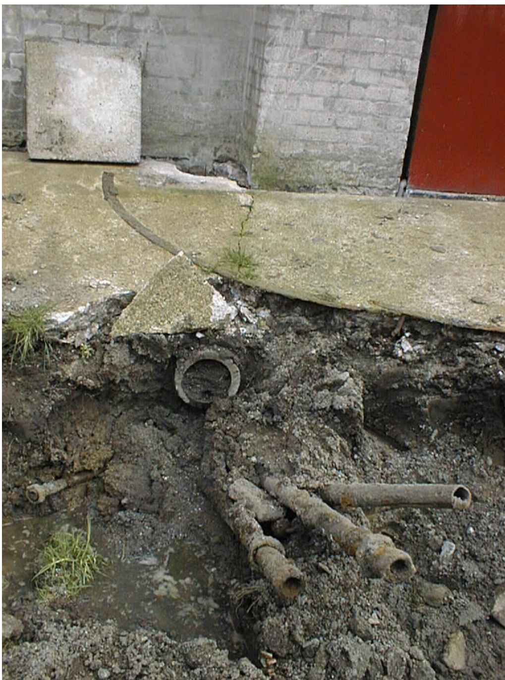
Rør til prøvestandenes brændstofforsyning på bygningens nordside.
